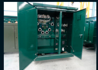
Transformadores tipo pedestal norma K0000-07 de 300 y 500 kVA
