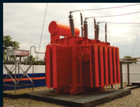
TRANSFORMADOR DE 12/14/16 MVA, 115/13.8 KV ONAN/ONAF, 55/65°C. PARA PLANTA CRYOINFRA, CARDENAS TABASCO
