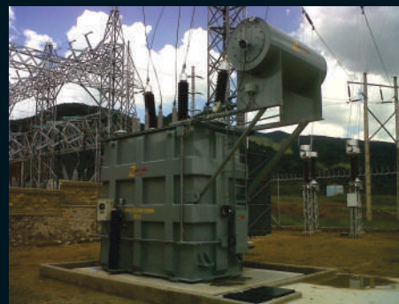
TRANSFORMADOR DE 10/12.5/15 MVA, 115/13.2 KV, PARA PLANTA ICO, TALPA DE ALLENDE, JALISCO.
