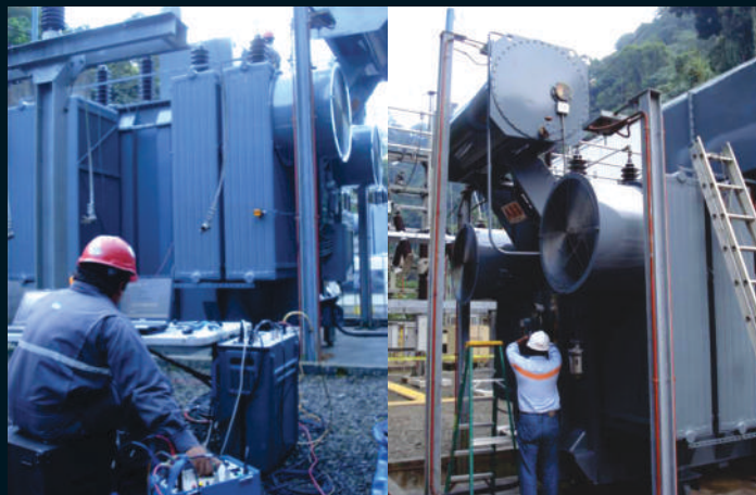
Reparación, instalación y puesta en marcha de transformador de Potencia 20/26 MVA, 69 kV a 13.2/7.6 kV. Hidroeléctrica el Canadá en Guatemala.
