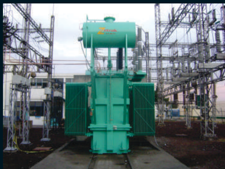
TRANSFORMADOR DE 18/24 MVA, 115/13.2 KV, PLANTA KIRIU, TOLUCA
