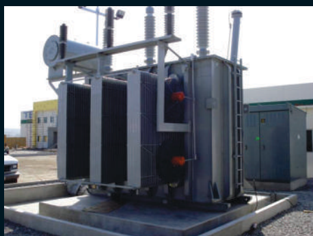
TRANSFORMADOR DE 6/7.5 MVA, 115/13.2 KV, PLANTA TOSHIBA, ROSARITO B.C. NORTE
